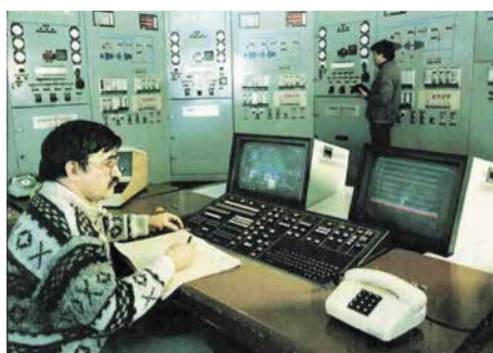
Пульт управления АСУ ТП ГОФО-1 диспетчерского пункта Первомайского ЛПУМГ
