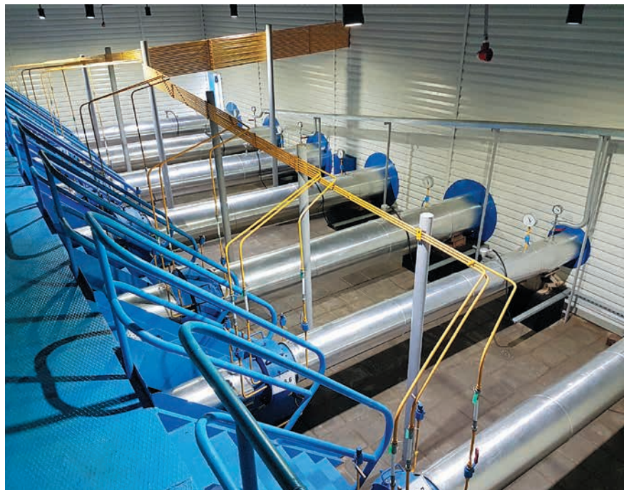
Узел учета КРП-14 после капремонта
